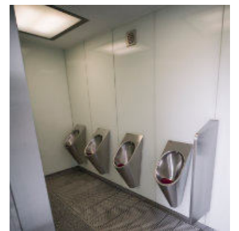
Pissoiranlage (Beispiel, Stadt München, Fa. HeringBau)
