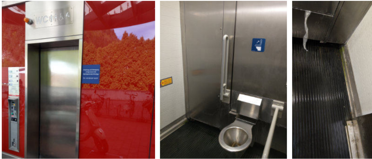
Selbstreinigende Toilettenanlage Brixlegg
