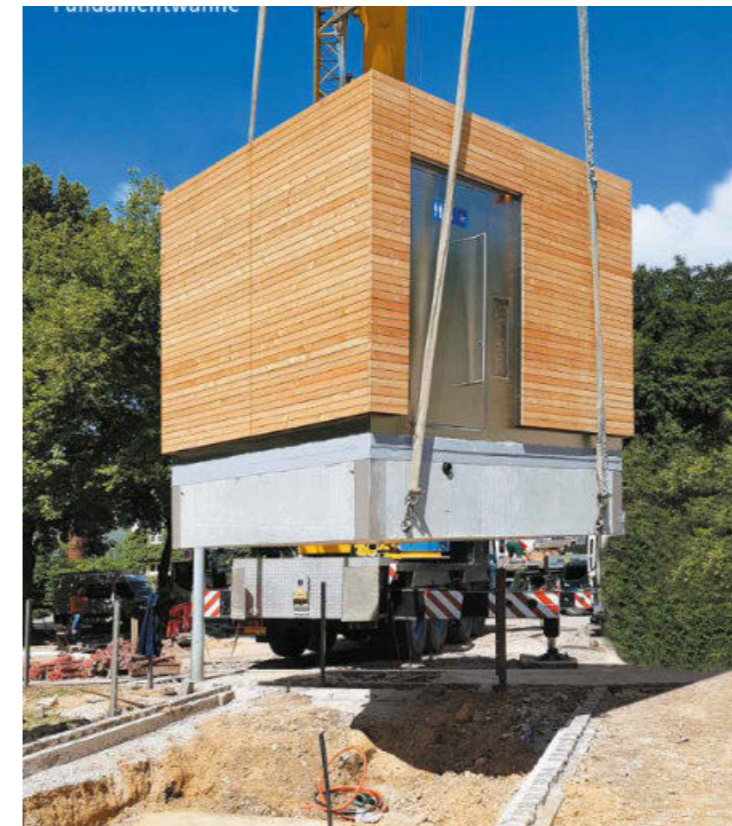
Quelle: Fa. Fierz GmbH - Beispiel für Anlieferung einer fertigen Modulanlage inkl. Fundament
